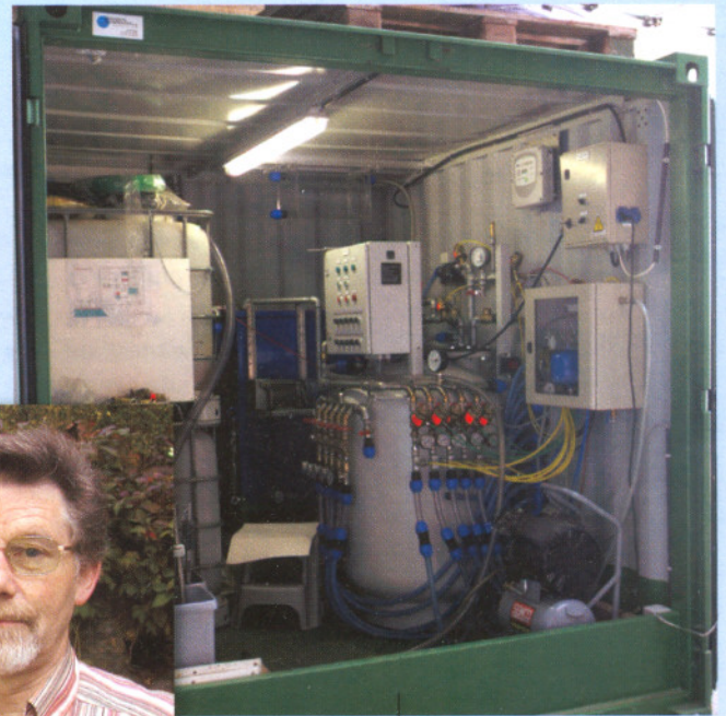
Le container de gestion des capteurs
